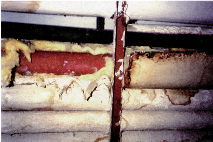
ΣΧ. 1.3α Η έλλειψη σωστής συντήρησης, εκτός από την καταστροφή των εγκαταστάσεων, κοστίζει και σε λειτουργικά έξοδα λόγω σπατάλης ενέργειας.
