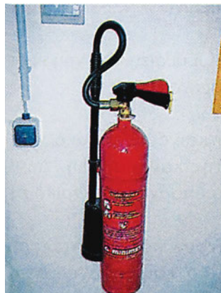
ΣΧ.10.4α Πυροσβεστήρας τοποθετημένος σε ειδική βάση στον τοίχο.
