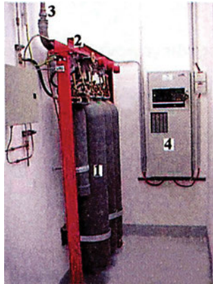
ΣΧ. 10.9α. Σταθμός διοξειδίου του άνθρακα (CO 2 ).
