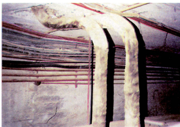
ΣΧ. 1.1α Χαρακτηριστική εικόνα εγκατάλειψης εγκαταστάσεων ξενοδοχείου. Είναι θέμα λίγων μηνών η καταστροφή των σωλήνων.
