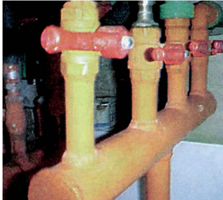
ΣΧ. 4.16.3α Κεντρικός συλλέκτης διανομής νερού και βάνες διακοπής και ρύθμισης ροής νερού.
