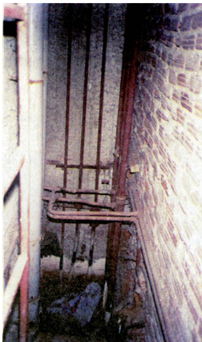
ΣΧ. 1.2α Σωλήνες μεταφοράς ζεστού νερού μέσα σε φρεάτιο κτιρίου. Η δυσκολία πρόσβασης στους σωλήνες (λόγω απουσίας ενδιάμεσων δαπέδων) οδήγησε στην εγκατάλειψη και διάβρωσή τους. Οι αιτίες πρέπει να αναζητηθούν, κυρίως, στη μελέτη και στην επίβλεψη του έργου. Υπάρχουν πολλά καινούρια κτίρια που τα εκτεταμένα δίκτυά τους χρειάζονται, ήδη, αντικατάσταση.
