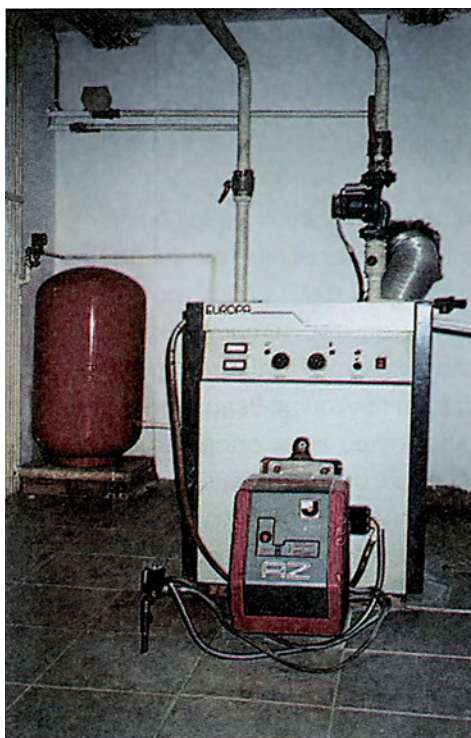
Εικ. (7.1) Λεβητοστάσιο κεντρικής θέρμανσης.
