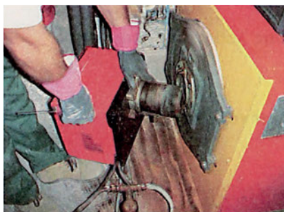
ΣΧ.9.4α Απομάκρυνση καυστήρα από το λέβητα.
