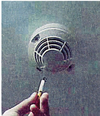
ΣΧ.10.13α Έλεγχος αισθητηρίου με καπνό.
