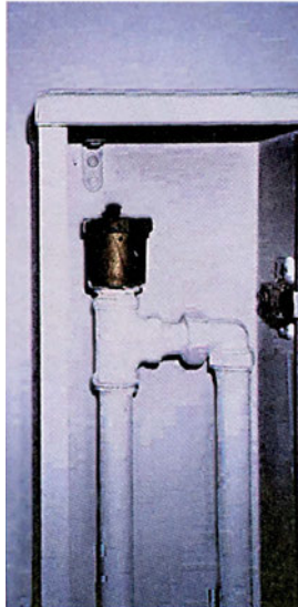
Εικ. (6.6β) Εξαέρωση δικτύου κεντρικής θέρμανσης με αυτόματο εξαεριστικό.
