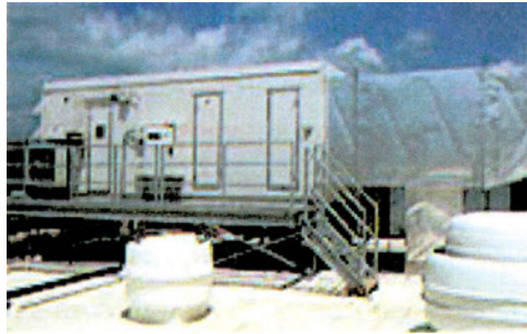
Εικόνα 1.17. Κεντρική μονάδα κλιματισμού αίθουσας χειρουργείου
