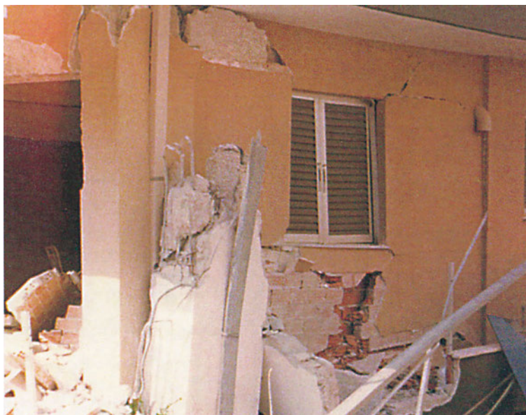
Φωτ. 11.1. Κατάσταση κτιρίου στην Καλαμάτα μετά τον σεισμό του 1986.
