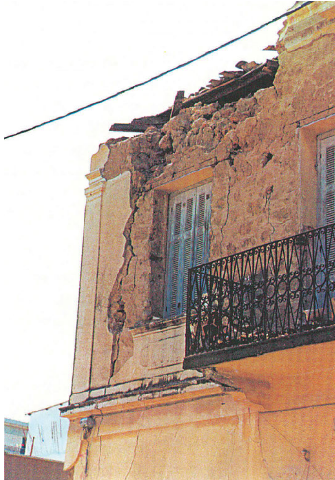
Φωτ. 8.5. Σεισμόπληκτο κτίριο.
