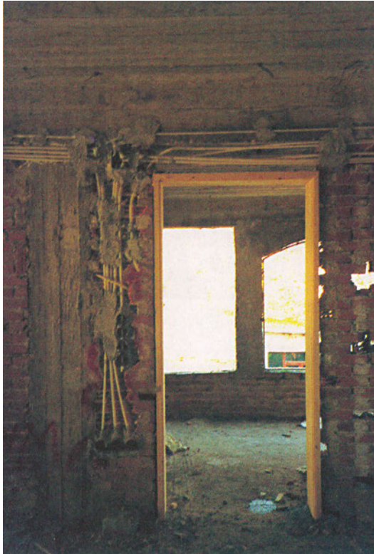
Φωτ. 11.3. Κακοτεχνίες σε οπτοπλινθοδομή.
