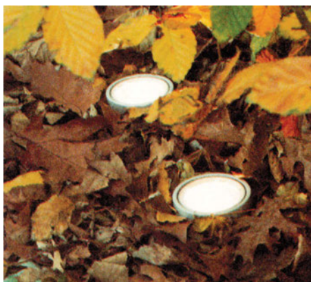
γ.39 Φωτιστικά τοποθετημένα απευθείας στο έδαφος χωρίς κορμό-φανοστάτη.
