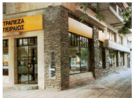
β.136 Η επένδυση των υποστυλωμάτων με σχιστόλιθους τονίζει τη θέση τους στην πρόσοψη, δημιουργώντας αντιθέσεις με τα υπόλοιπα υλικά.
