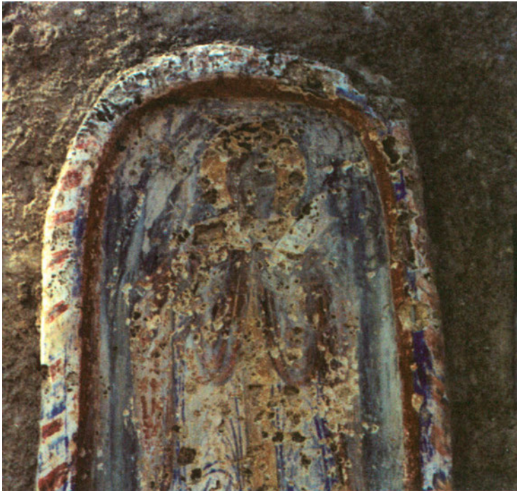
Φθορές τοιχογραφίας που βρίσκεται στην εξωτερική όψη ναού, σε παραθαλάσσια περιοχή
