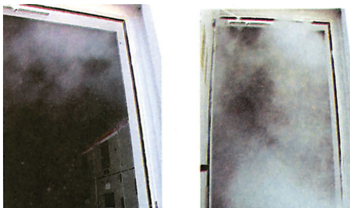
ΣΧ.10.4.γ Αριστερά μόλις έχει αρχίσει η εκκένωση διοξειδίου του άνθρακα πάνω από τους ηλεκτρικούς πίνακες. Δεξιά, το \text{CO}_2 έχει κατακλύσει όλο τον χώρο. Οι συνθήκες είναι αποπνικτικές και ιδιαίτερα επικίνδυνες.
