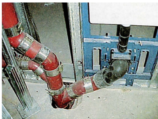
ΦΩΤ. 3.4.γ Λεπτομέρειες από πολλαπλή σύνδεση σωλήνων αποχέτευσης. Οι σωστές γωνίες και τα πολλά κολάρα ένωσης και στήριξης των σωλήνων εξασφαλίζουν την καλή λειτουργία του δικτύου.
