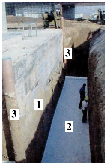
ΣΧ.4.9.2.γ Περιμετρική τάφρος αποστράγγισης υπογείων υδάτων. Διακρίνονται ο τοίχος του υπογείου (1), το νάλον που σκεπάζει το χαλίκι (2) και ο σωλήνας μέσα στον οποίο τοποθετείται η αντλία απομάκρυνσης των νερών (3).
