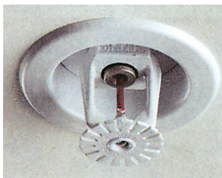
ΣΧ. 10.2.3.β Καταιονητήρας τοποθετημένος στην οροφή οικοδομής. Η πυκνότητα των καταιονητήρων εξαρτάται από το είδος του κτιρίου, την ποσότητα εύφλεκτων υλικών κλπ.
