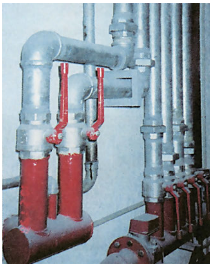
ΣΧ. 10.3.1.α Δίκτυο πυρόσβεσης κατασκευασμένο από γαλβανισμένους σιδηροσωλήνες. Οι ενώσεις των σωλήνων γίνονται με σπείρωμα.
