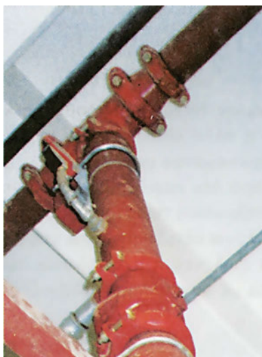
ΣΧ.10.3.1.β Εύκαμπτο λυόμενο δίκτυο πυρόσβεσης, κατασκευασμένο από βαμμένους σιδηροσωλήνες. Οι ενώσεις των σωλήνων γίνονται με ειδικούς συνδέσμους. Πρόκειται για νεότερης τεχνολογίας δίκτυο, το οποίο αντέχει πολύ στους σεισμούς.
