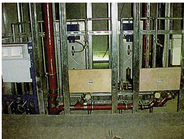
ΦΩΤ. 3.4.β Εγκαταστάσεις ύδρευσης-αποχέτευσης στηριζόμενες σε διαχωριστικό πάνελ κτιρίου. Οι σωλήνες ύδρευσης είναι από γαλβανισμένους σιδηροσωλήνες ενώ αυτοί της αποχέτευσης μαντεμένιοι.
