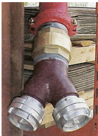
ΣΧ. 10.2.2.α Δίδυμο πυροσβεστικό υδροστόμιο, σε βιομηχανία.
