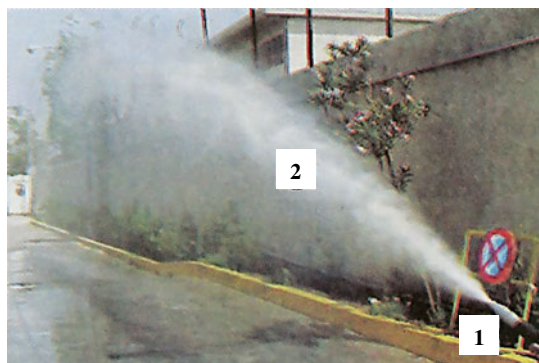
ΣΧ.10.5.α Ο τακτικός έλεγχος καλής λειτουργίας διασφαλίζει την ετοιμότητα ενός μόνιμου πυροσβεστικού δικτύου.
