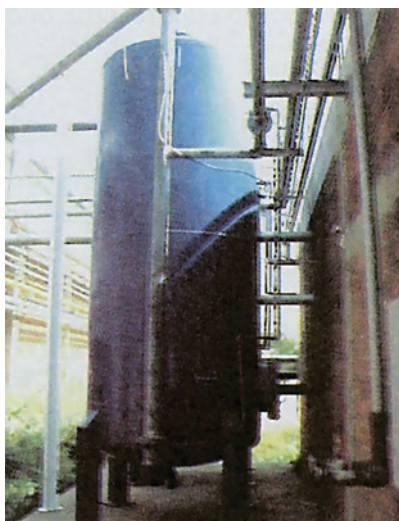
ΣΧ.9.2.2.β Δοχείο βιομηχανικού πιεστικού συγκροτήματος, χωρητικότητας 16m^3 , που λειτουργεί με πεπιεσμένο αέρα. Το δοχείο αυτό καλύπτει μικρές καταναλώσεις, χωρίς να ξεκινά η λειτουργία της αντλίας.
