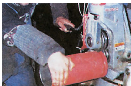
ΣΧ.10.3.1.γ Για τα λυόμενα δίκτυα απαιτείται η κατασκευή ενός αυλακιού, στα άκρα των σωλήνων. Στο αυλάκι αυτό, το οποίο γίνεται με τη βοήθεια της εικονιζόμενης μηχανής, “κουμπώνει” το ειδικό εξάρτημα σύνδεσής τους. Επισημαίνουμε τα προστατευτικά μανίκια που φορά ο τεχνίτης καθώς και την απουσία δακτυλιδιών και ρολογιού, προκειμένου να αποφευχθεί το ενδεχόμενο ατυχήματος, καθώς περιστρέφεται ο σωλήνας.
