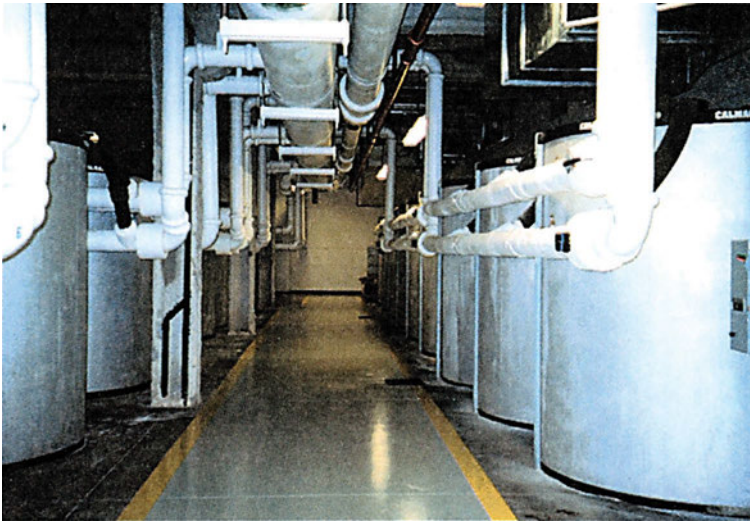
Εικόνα 1.13: Συγκρότημα δεξαμενών για την αποθήκευση πάγου.
