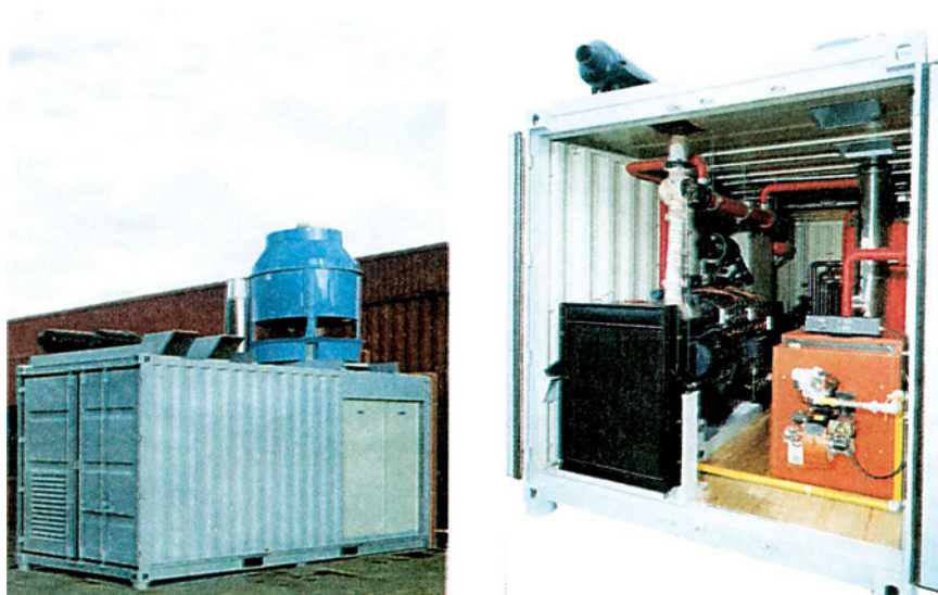
Εικόνα 1.11: Μονάδα συμπαραγωγής ηλεκτρικής ενέργειας – θερμότητας - ψύχους. Αριστερά εξωτερική μονάδα και δεξιά λεπτομέρεια από τον εσωτερικό χώρο της μονάδας.
