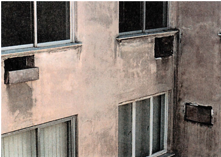
Εικόνα 3.6: Τρύπες στη τοιχοποιία μετά την αφαίρεση μονάδων monoblock.
