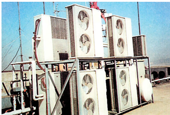
Εικόνα 3.2: Συνδυασμός μονάδων διαιρούμενου τύπου για να καλυφθούν οι ανάγκες σε κλιματισμό πολλών εσωτερικών χώρων.
