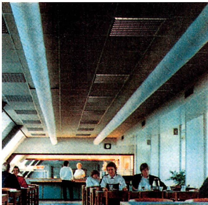
Εικόνα 5.8: Εγκατεστημένοι υφασμάτινοι αεραγωγοί για τον κλιματισμό μιας αίθουσας εστιατορίου.
