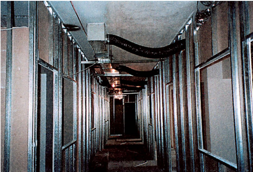
Εικόνα 5.2: Κεντρικός αεραγωγός εξαερισμού, κατά μήκος (στο άνω αριστερό μέρος) ενός διαδρόμου σε χώρο γραφείων. Ο αεραγωγός συνδέεται, στη δεξιά πλευρά του, με εύκαμπτους αεραγωγούς που καταλήγουν σε στόμια εξαερισμού μέσα στα γραφεία.
