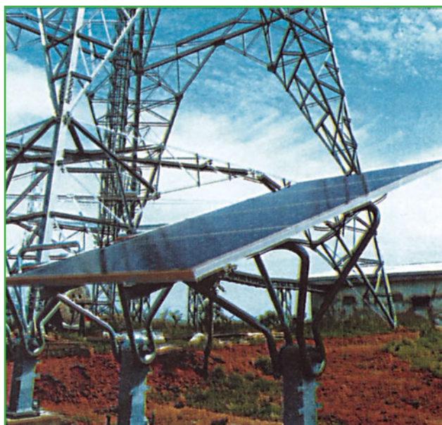
Εικόνα 7. 1: Φωτοβολταϊκά συστήματα συνδεδεμένα στο δίκτυο της ΔΕΗ
