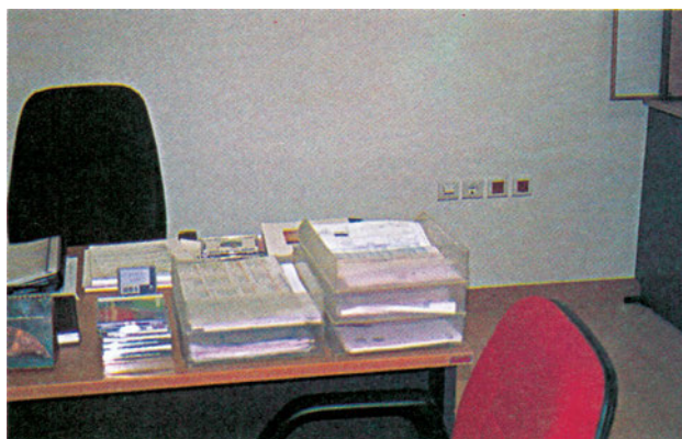
Χώρος εργασίας με εγκατάσταση δομημένης καλωδίωσης
