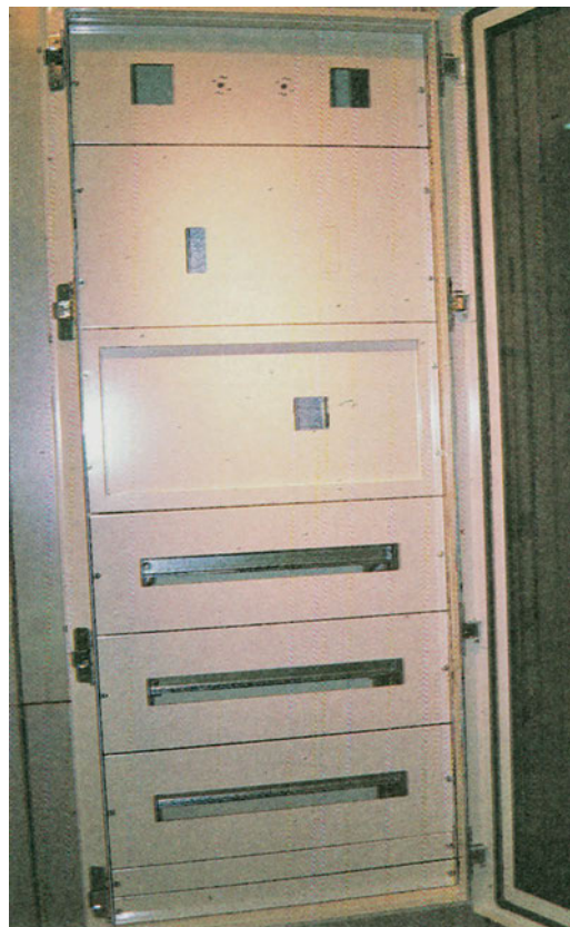
Μεταλλικό κιβώτιο πίνακα κίνησης
