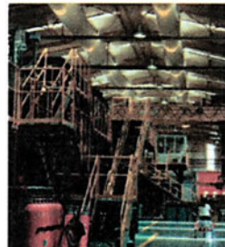
Διάτρητος πλαστικός αεραγωγός οροφής, για τη διανομή αέρα
