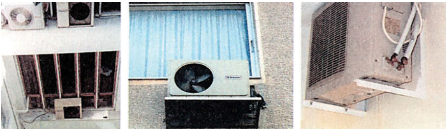
Εικόνα 3.11: Διάφοροι τρόποι τοποθέτησης εξωτερικών μονάδων σε φωταγωγό επί του δαπέδου (αριστερά) και σε εξωτερικούς τοίχους, είτε σε βάση στήριξης (κέντρο), είτε σε μεταλλικές γωνίες (δεξιά).
