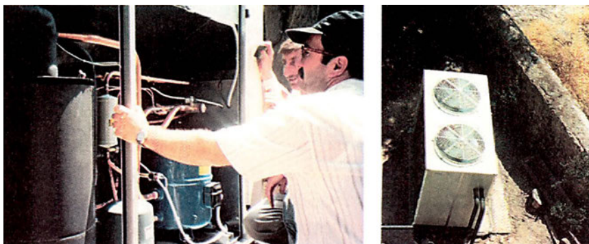
Εικόνα 3.3: Εξωτερική κεντρική μονάδα αντλίας θερμότητας αέρα-νερού μεσαίου μεγέθους (30 kW). Αριστερά, τα εξαρτήματα της αντλίας θερμότητας, αφού έχει αφαιρεθεί το προστατευτικό κάλυμμα της μονάδας. Δεξιά, οι δυο αξονικοί ανεμιστήρες της μονάδας. Σημ.: Για τη διανομή του ζεστού/κρύου νερού στις τοπικές κλιματιστικές μονάδες, χρησιμοποιείται μία αντλία.
