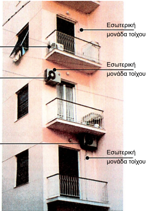
Εικόνα 3.10: Εξωτερικές μονάδες κλιματιστικών, διαιρούμενου τύπου, για μικρούς χώρους μιας κατοικίας με διάφορους τρόπους εγκατάστασής τους (ορθούς-λανθασμένους).
