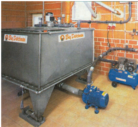
Εικ. 4.18 α Συγκρότημα (κουζίνα) παρασκευής και διανομής υγρής τροφής σε χοιροστάσιο ελεγχόμενο ηλεκτρονικά
