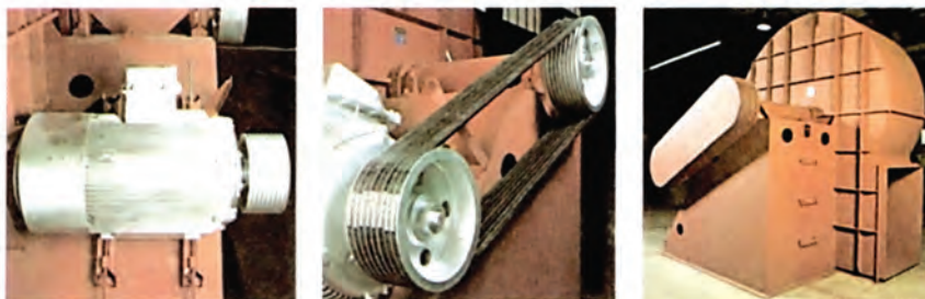
Εικ. 14.9α Ιμαντοκίνηση παραδείγματος εφαρμογής
