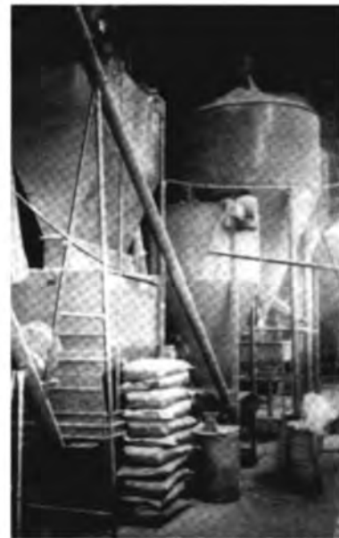
Εικόνα 10-26: Σφυρόμυλος και αναμικτήρας στο εσωτερικό μιας βιομηχανίας ζωοτροφών
