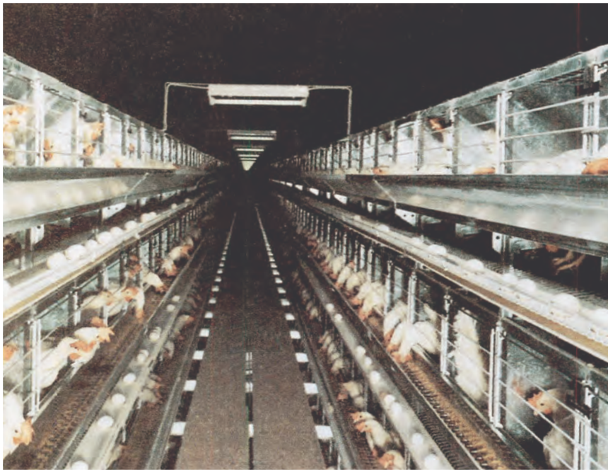
Εικόνα 5-41. Κλωβοστοιχίες ορνίθων αυγοπαραγωγής, τριώροφες. Στην οροφή του κτιρίου φαίνονται οι λαμπτήρες φωτισμού, κατανεμημένοι για τον ομοιόμορφο φωτισμό των ορνίθων.
