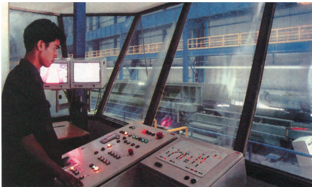
Σχήμα 3.10: Τράπεζα χειρισμών εγκατάστασης αυτοματισμού.
