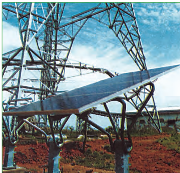
Εικόνα 7. 1: Φωτοβολταϊκά συστήματα συνδεδεμένα στο δίκτυο της ΔΕΗ
