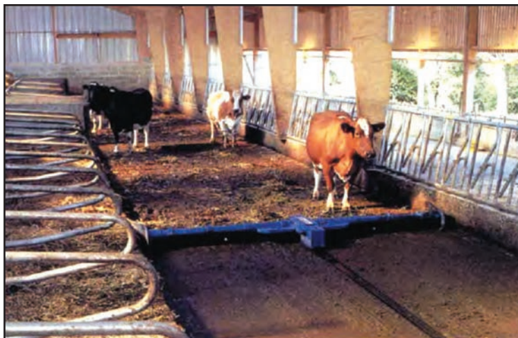
Εικόνα 6.77: Μηχανικό ξέστρο καθαρισμού του διαδρόμου κυκλοφορίας στάβλου ελεύθερου σταβλισμού
