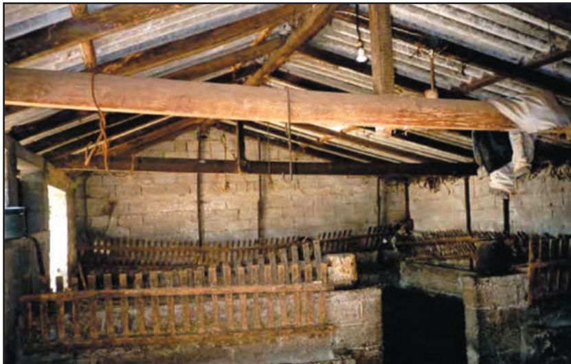
Εικόνα 13.41: Εσωτερικό στάβλου προβάτων και αιγών χωρίς ανοίγματα αερισμού στους τοίχους και στην οροφή
