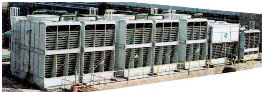
Σχήμα 8-73: Συγκρότημα πύργων ψύξης εγκατάστασης βιομηχανικού κλιματισμού.
