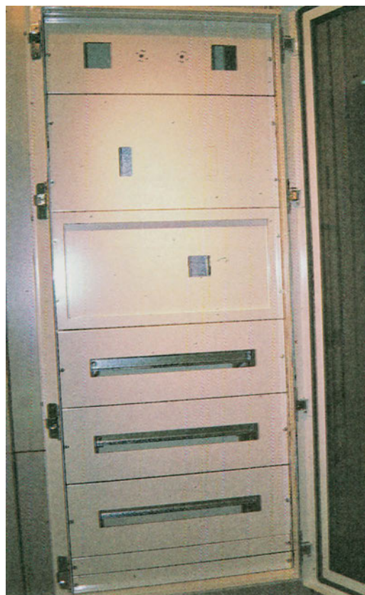
Μεταλλικό κιβώτιο πίνακα κίνησης
