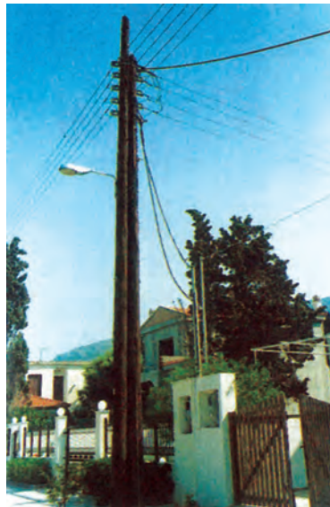
Φωτογραφία 6.1.1 Εναέριες παροχές και μετρητές ηλεκτρικής ενέργειας
