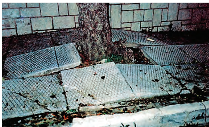
Εικ. 10.7 Πλάκες πεζοδρομίου ανασηκωμένες από δέντρο δεντροστοιχίας
