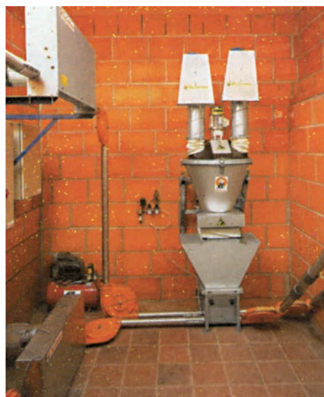
Εικ 4.18 β Συγκρότημα (κουζίνα) ανάμειξης και διανομής διαφόρων τύπων μειγμάτων διατροφής ξηρής μορφής με mixer 100 λίτρων ελεγχόμενο ηλεκτρονικά
